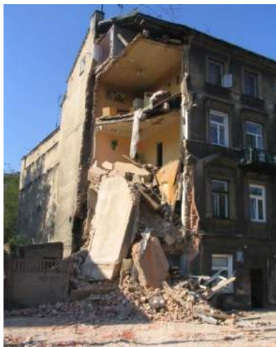
Fotografia nr 12.1. Obiekt budowlany częściowo zniszczony na skutek niewłaściwej eksploatacji (KM PSP Radom).
